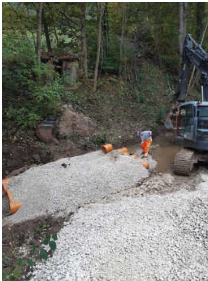
Zur Sicherung der Böschung wurden als Sofortmaßnahme Abflussrohre in den Bach gelegt.
