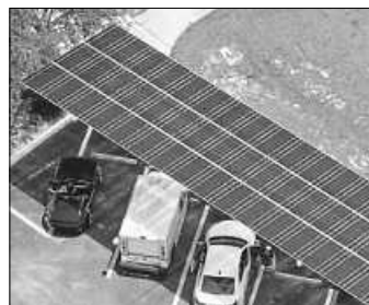
PV auf Parkplatz
